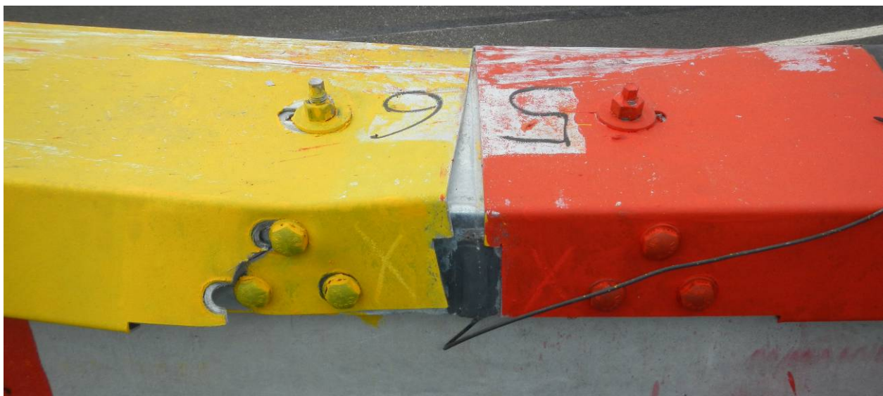
Bild 15 Gerissene Verbindungslöcher im Stoß 5/6 der Sanierungslösung (Ansicht von hinten)
