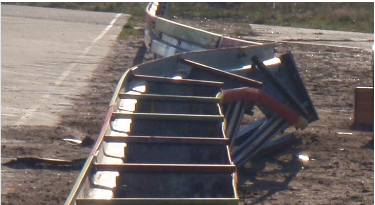
Bild 8: Auslenkung der Übergangskonstruktion im Primäranprallbereich (gegen die Anprallrichtung gesehen)
