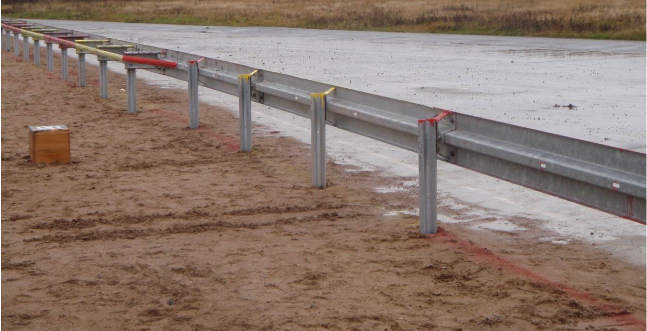
Bild 1: Übergangskonstruktion (Ansicht in Anprallrichtung)
