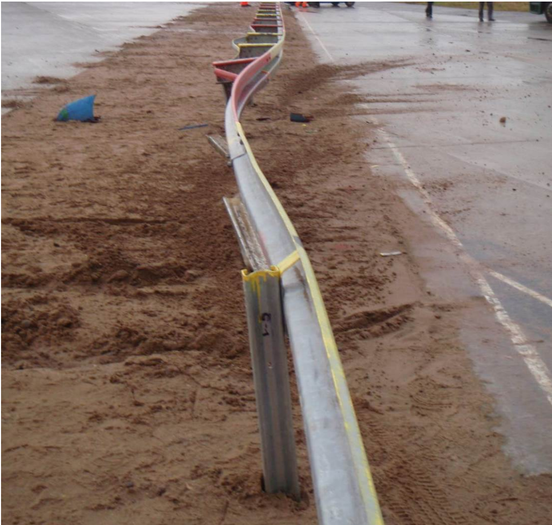
Bild 9: Auslenkung der Übergangskonstruktion im Primäranprallbereich (in Anprallrichtung gesehen)
