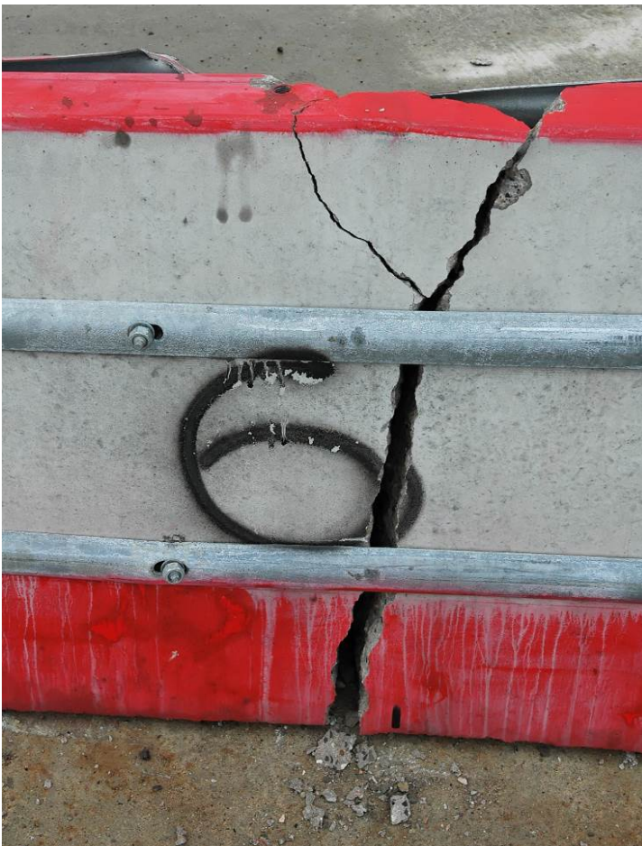
Bild 21: gebrochenes Betonfertigteile Systemrückseite (Detail)
