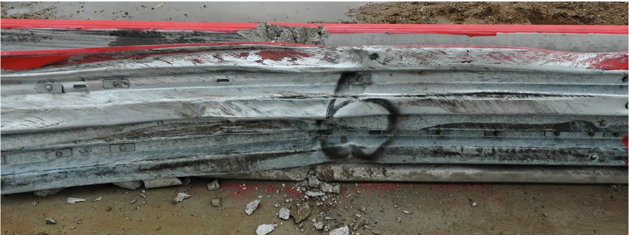
Bild 17: gebrochenes Betonfertigteilelement bei Element 6
