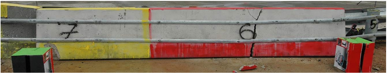
Bild 20: gebrochenes Betonfertigteile Systemrückseite
