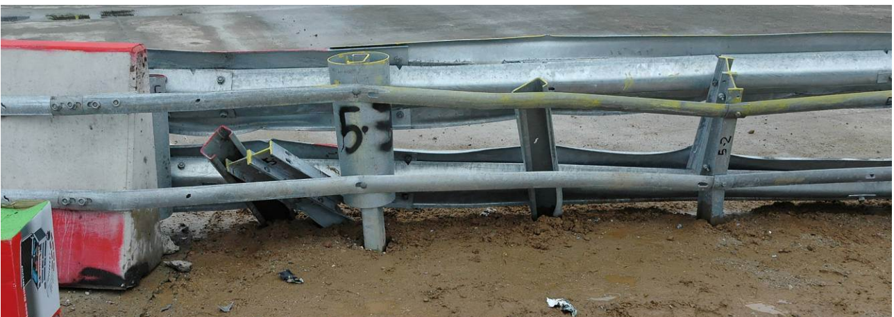
Bild 19: Beschädigungen am Übergang zum Betonfertigteilelement
