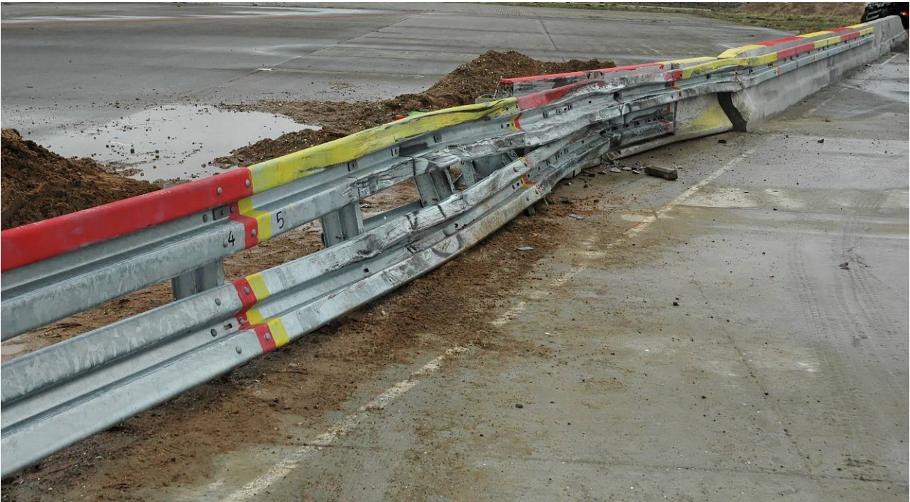
Bild 12: Übergangskonstruktion nach dem Versuch (Ansicht der Systemvorderseite von vorne in Anprallrichtung)
