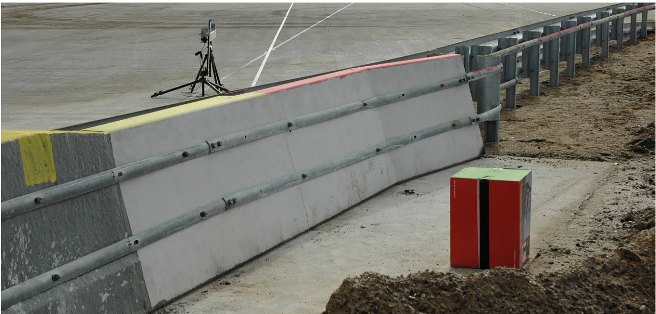
Bild 17: Betonfertigteil nach dem Anprall (Ansicht Systemrückseite entgegen Anprallrichtung)
