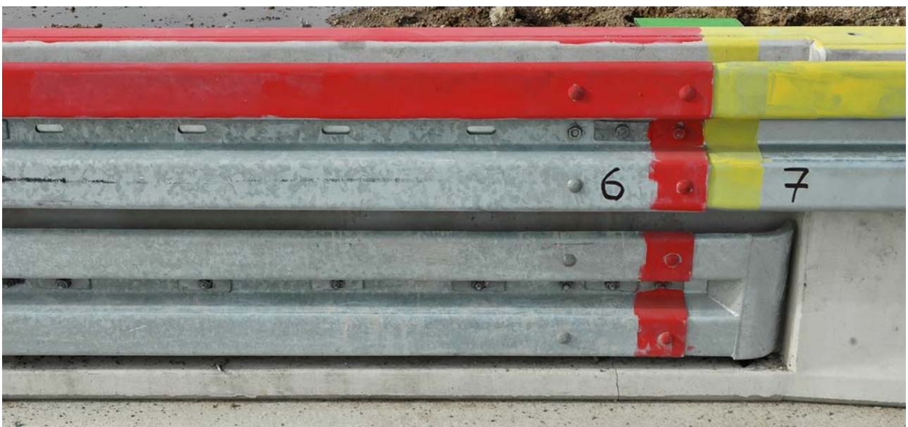
Bild 19: Leichte Beschädigung am Betonfertigteil Stoß 6/7 vorne unten
