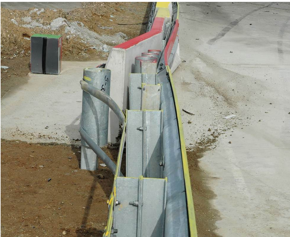
Bild 16: Auslenkung der Übergangskonstruktion (Ansicht in Anprallrichtung)
