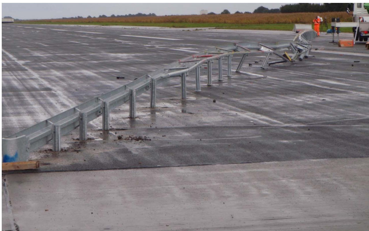
Bild 9: Schutzeinrichtung nach Crash (Ansicht Systemrückseite entgegen Anprallrichtung)
