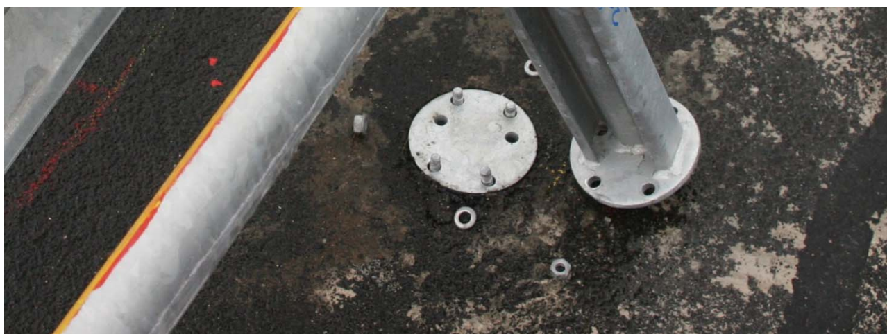
Bild 13: Vollständig gelöste Verschraubung bei Steckpfosten 3-2 (Detail)
