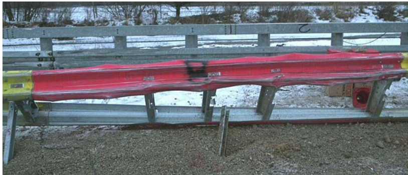
Bild 21: Schäden am Element 8
