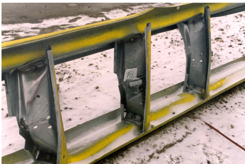
Bild 24: Detail: Schäden im Bereich des Distanzstücks 18 (Element 9)
