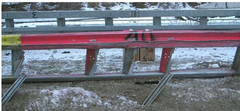
Bild 23: Schäden am Element 10
