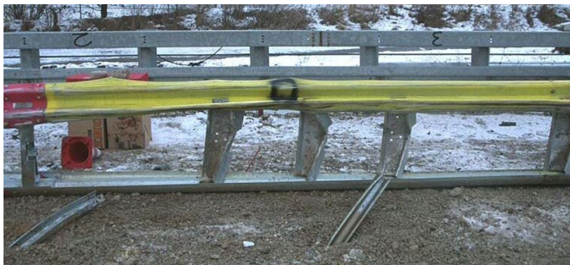
Bild 22: Schäden am Element 9
