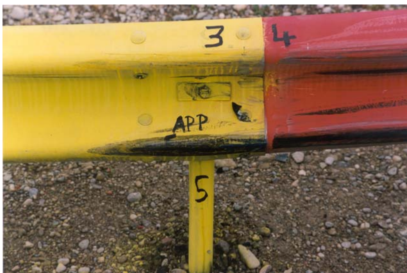
Bild 14: Schäden am Anprallpunkt
