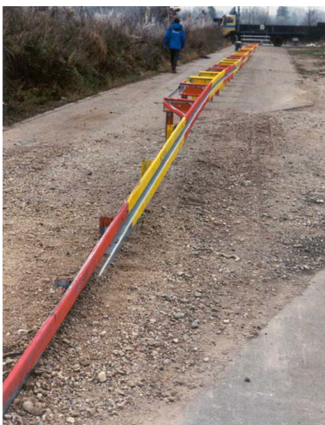
Bild 18: Verschiebung der angeschlossenen Schutzeinrichtung
