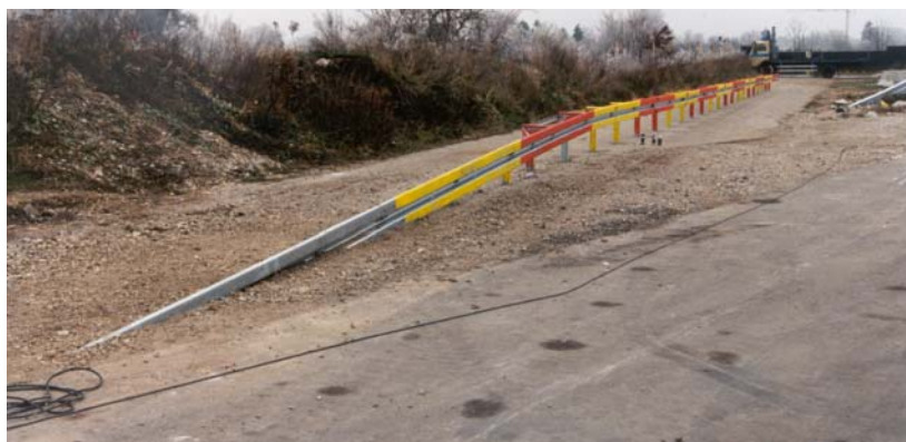
Bild 1: Anfangs- und Endkonstruktion mit angeschlossener Schutzeinrichtung
