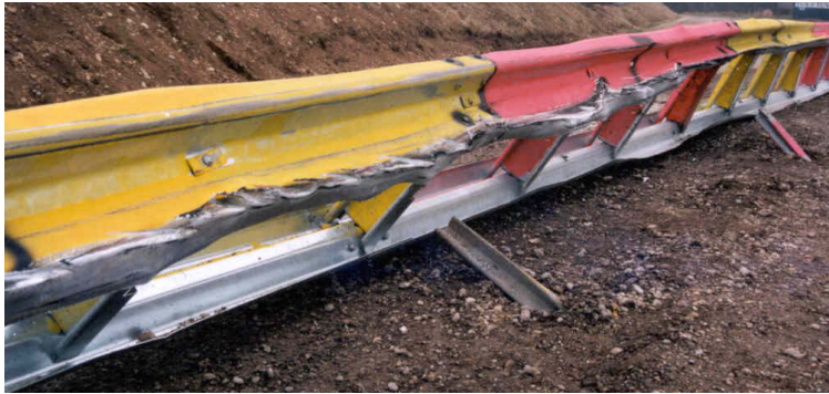
Bild 19: Detail: Schäden an Holmen 6/7
