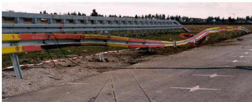
Bild 9: Schäden am tatsächlichen Anprallpunkt
