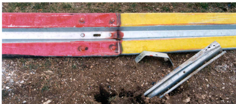
Bild 14: Detail: abgetrennter Pfosten
