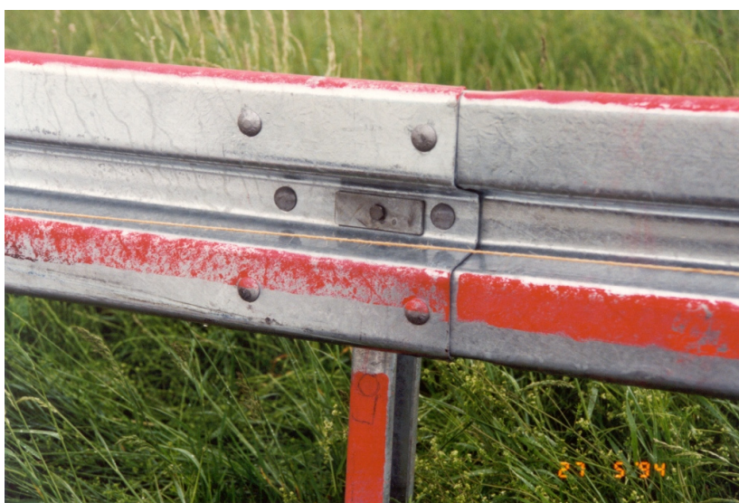
Bild 12: Fortsetzung der Kontaktstrecke (Schäden Element 9)
