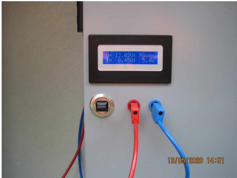
Abbildung 45: Wattmeter im Kabelverzweigerschrank
