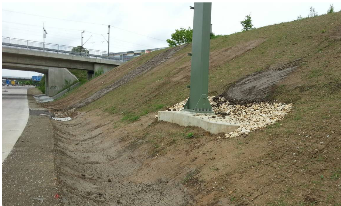
Anprallsockel gemäß RIZ VZB 4 aber dennoch Gefährdungsstufe 1 nach RPS (Foto: Heike Becker)
