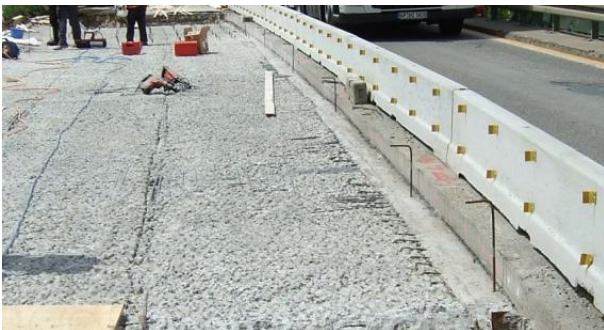
Bild 18: Aufgeraute Betonplatte des Überbaus (Erfahrungssammlung Beispiel 3.2)
