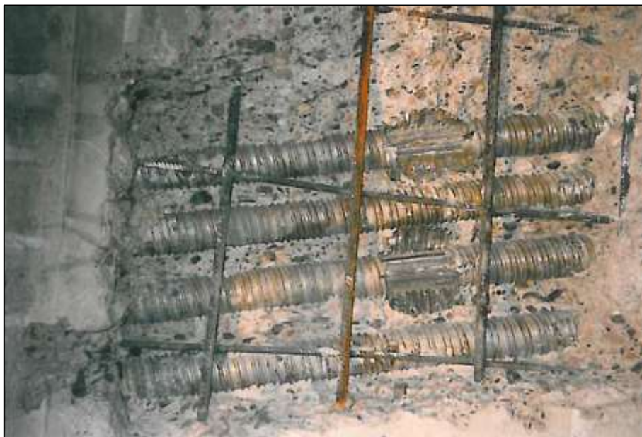
Bild 2: Freigelegte Spannglieder (Überbau Nord, TBW 2), leichte Korrosion
