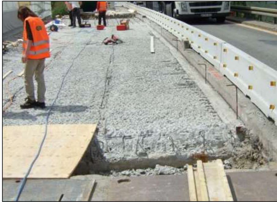
Bild 6: Aufgeraute Betonplatte des Überbaus
