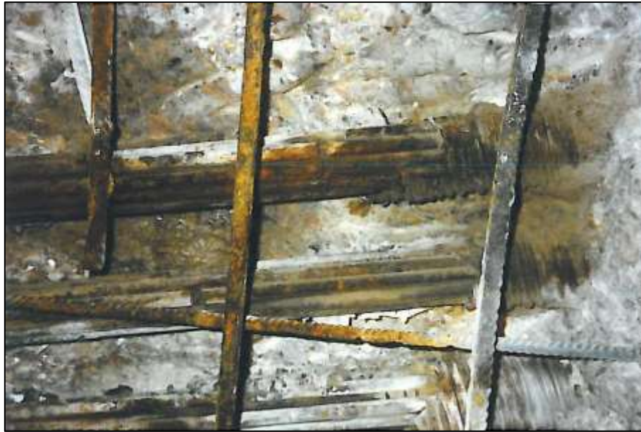
Bild 3: Schadensstelle Überbau Nord (TBW 2)
