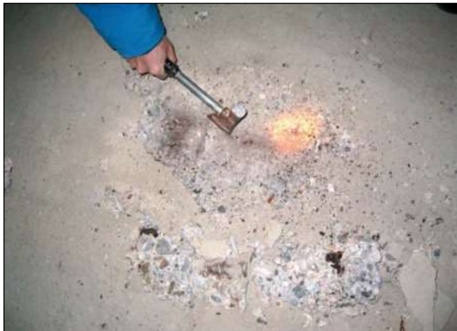
Bild 3: Betonabplatzung und korrodiertes Spannglied
