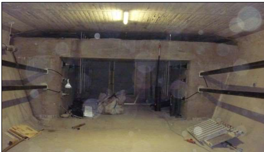
Bild 4: Verankerung der nachträglich ergänzten Spannglieder am Endquerträger und Lage im Inneren des Hohlkastens (Endfeld)
