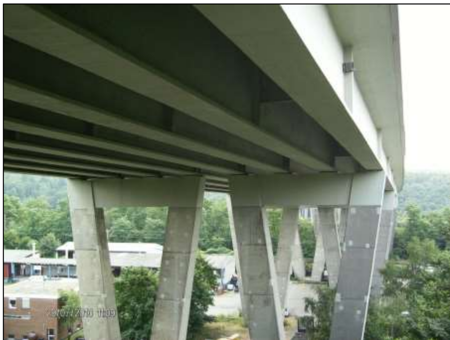
Bild 6: Untersicht nach Verstärkung
