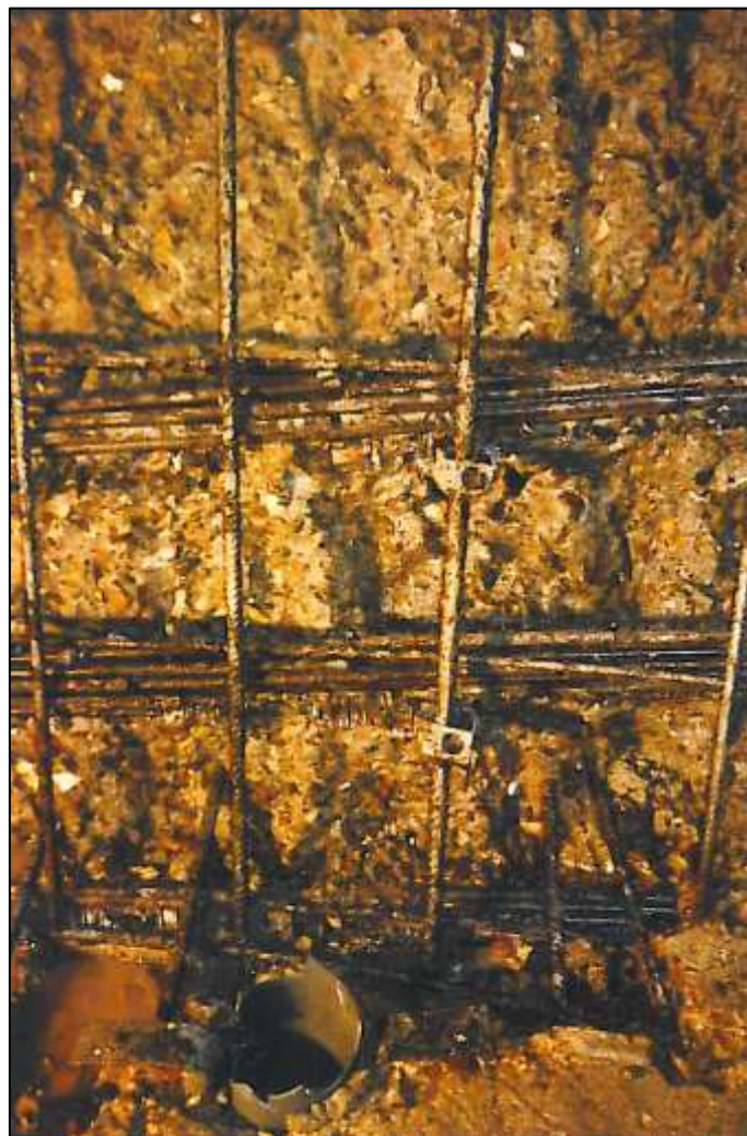
Bild 4: Schadensstelle Überbau Süd (TBW 1)
