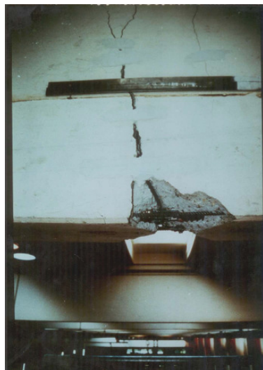
Bild 7 Rissbild eines Schadenfalles [14]
