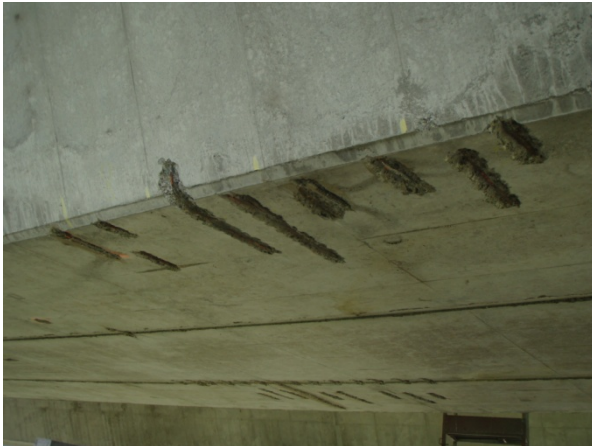
Abb.: freigelegte Schadstellen des Spannbetonüberbaus
