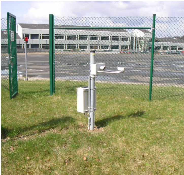
Abbildung 5: Niederschlags- messgerät, Messquer- schnitt an der Bundes- autobahn A4 auf dem Bast-Gelände
