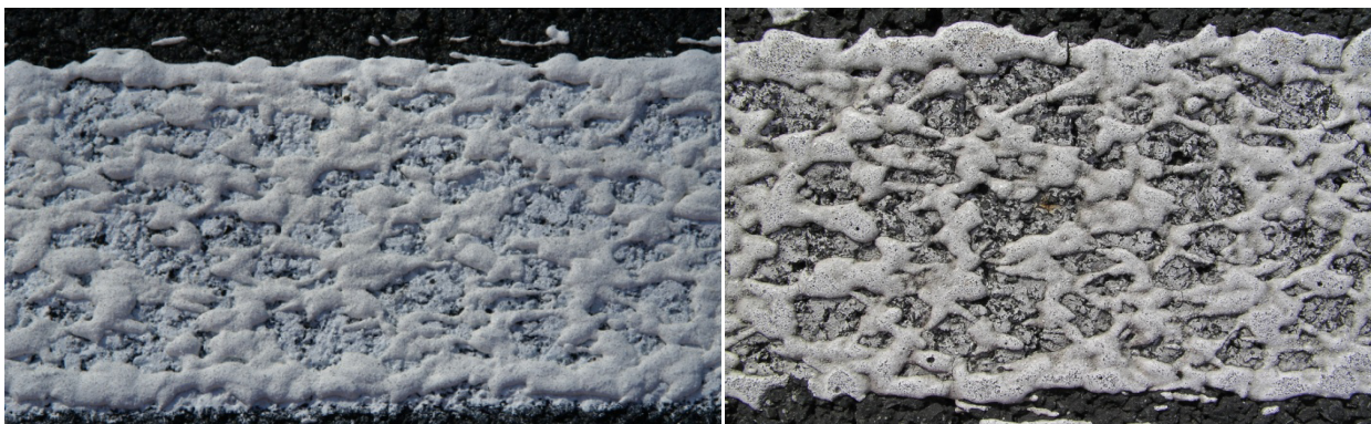
Abbildung 4-30: Vorher-Nachher-Vergleich Maßnahme 1 (verschiedene Standorte)
