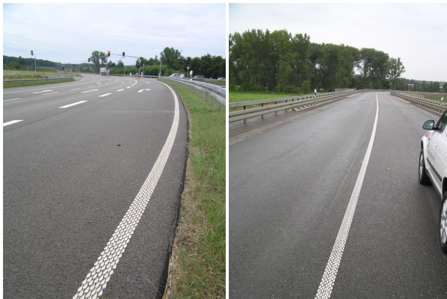
Abbildung 4-31: Messung auf der rechten Fahrbahnbegrenzung am Messpunkt 1 (links) und auf der Fahrstreifenbegrenzung am Messpunkt 2 (rechts)
