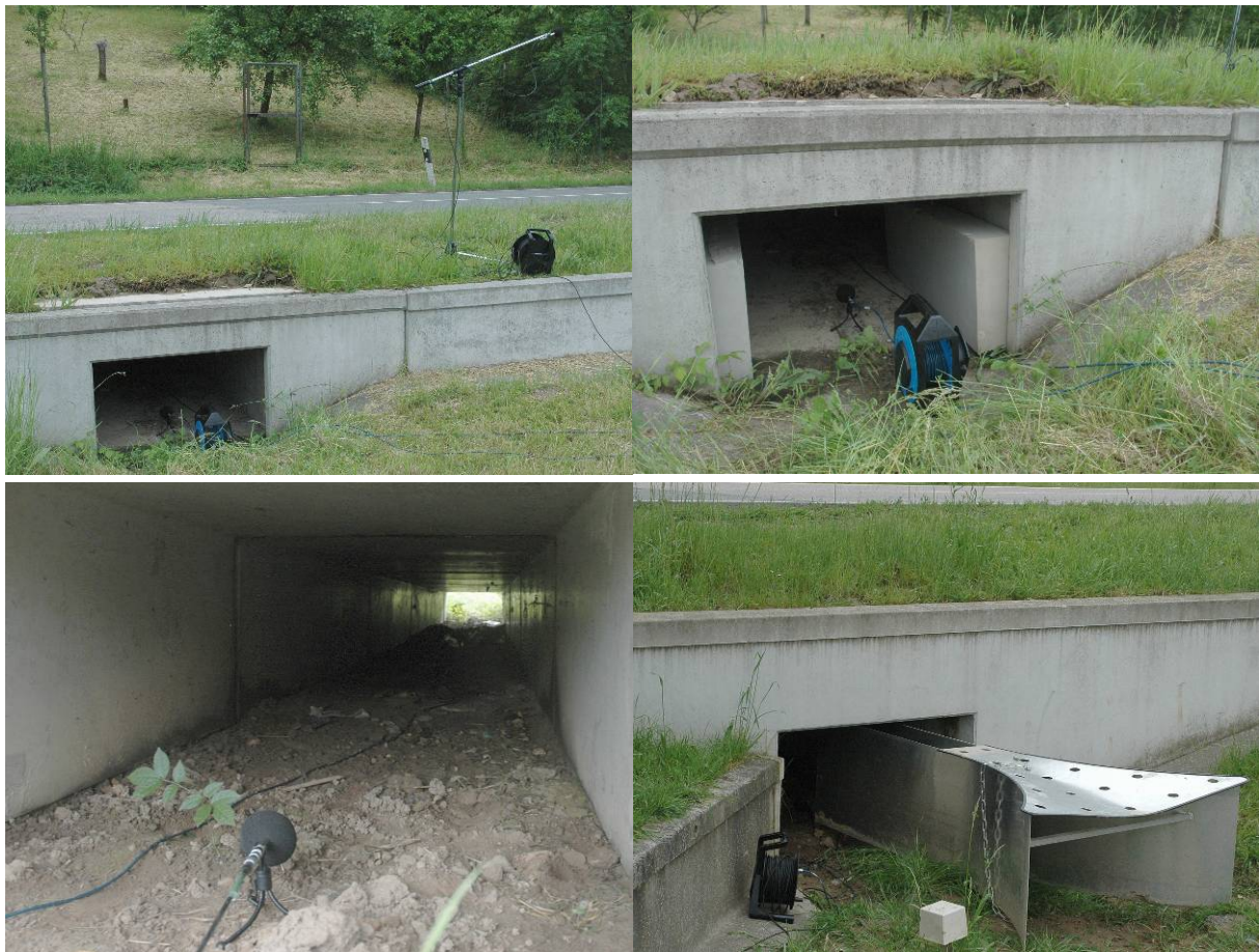
Abbildung 13: Messungen des Schalldruckpegels in zwei Stelztunneln der Amphibienschutzanlage an der B 3 bei Karlsruhe
