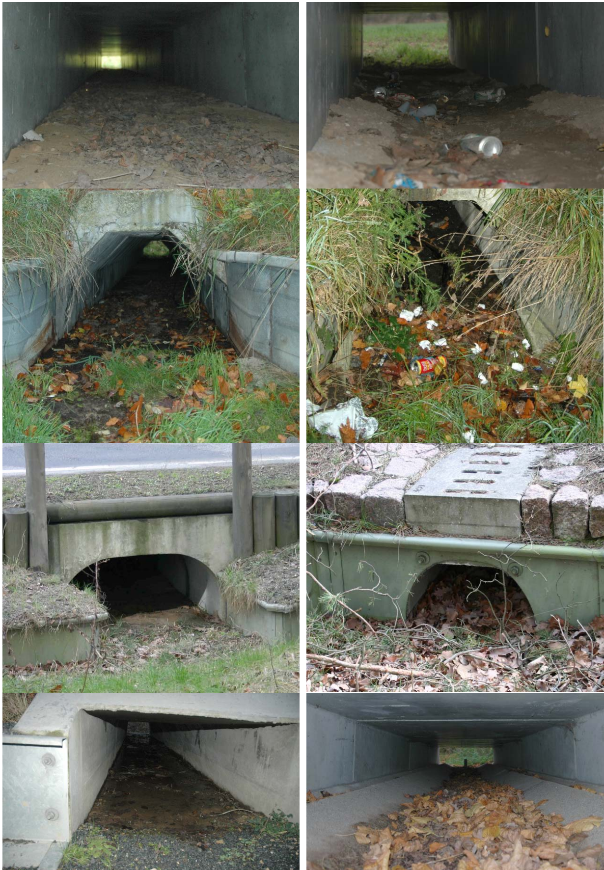
Abbildung 43: Beispiele zur Untersgrundsituation vor und in verschiedenen Durchlässen 1. Reihe links: B9, rechts: B3; 2. Reihe links und rechts: B49; 3. Reihe links und rechts: B96; 4. Reihe links: Bruchstraße, rechts: Parkstraße
