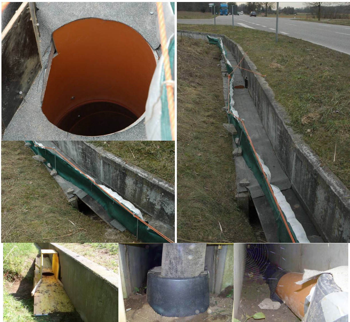
Abbildung 22: Montage eines Fallrohrs an je einem Tunneleingang eines Stelztunnels an der B 3 bei Karlsruhe im Frühjahr (oben) sowie im Sommer (unten) 2009
