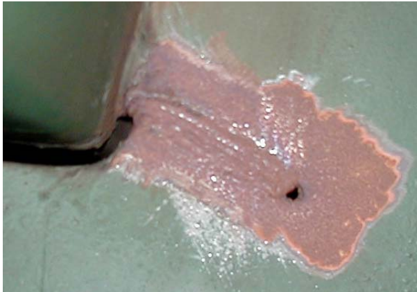
Bild 9. Durch Schweißen sanierter Riss, Autobahnbrücke Karlsruhe
