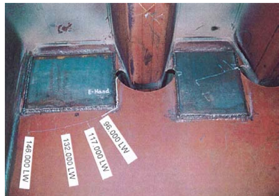
Bild 11: Riss wurde übertragen durch die Schweißnaht auf das Verstärkungsblech (vorhandene Risse werden vor dem Aufpflastern nicht zugeschweißt)
