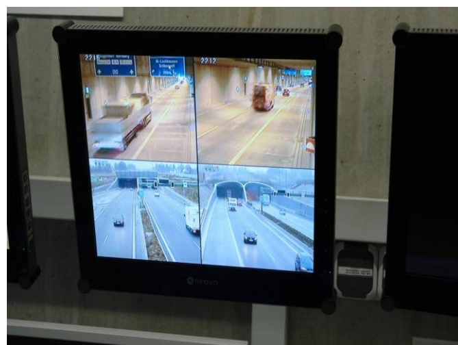
Bild 2: Videobeobachtung in einer Tunnelleitzentrale (TLZ) oder bei der Feuerwehr bzw. Polizei
