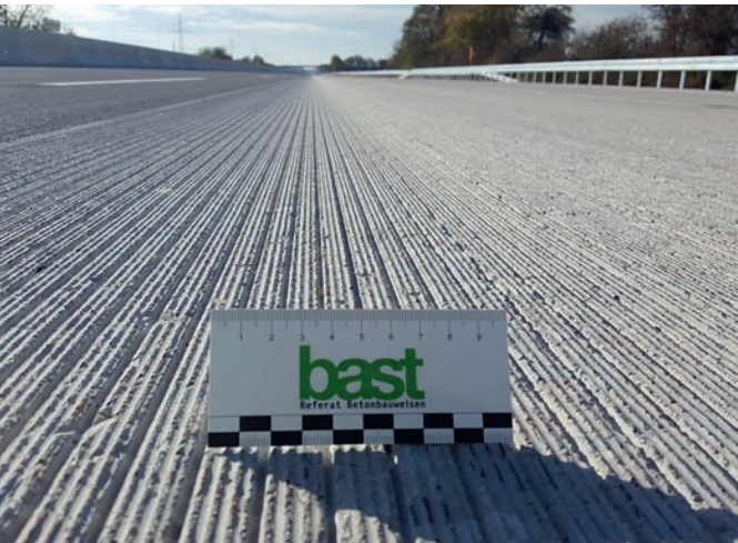
Fahrbahnoberfläche Texturgrinding: Typ S+ 2,4/2,2 – 2,4/18
