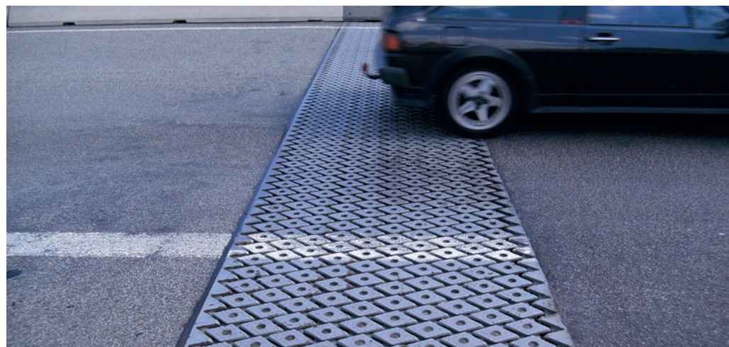
Fahrbahnübergang in Lamellenbauweise mit Lärminderung
