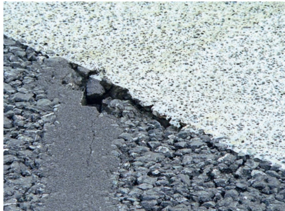
Ausbrüche an den Fugenflanken
