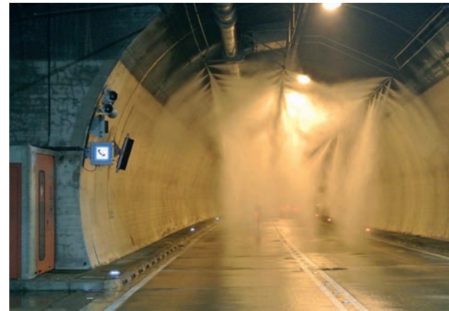
Brandbekämpfungsanlage vom Typ Wasserdampf zum Zeitpunkt der Aktivierung
