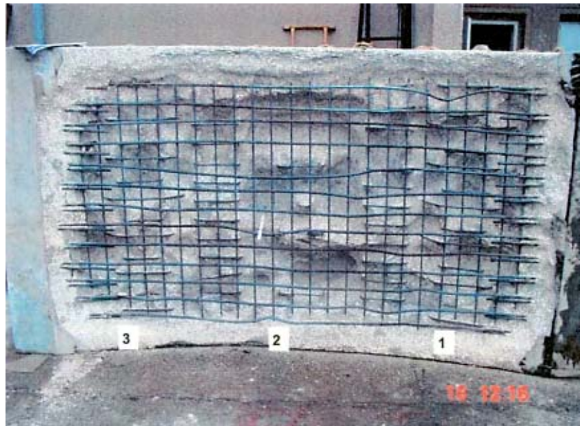
Tunnelbeton ohne PP-Fasern nach Brandversuch, freiliegende oberflächennahe Bewehrung (Foto: MFPA Leipzig)
