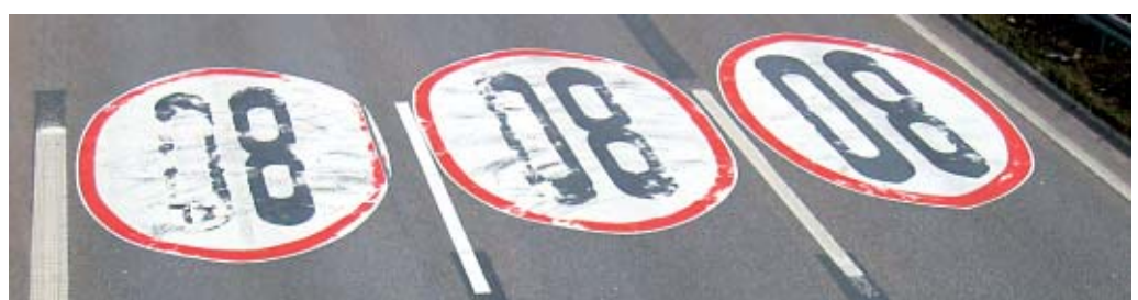
Markierte Verkehrszeichen unterliegen einem hohen Verschleiß
