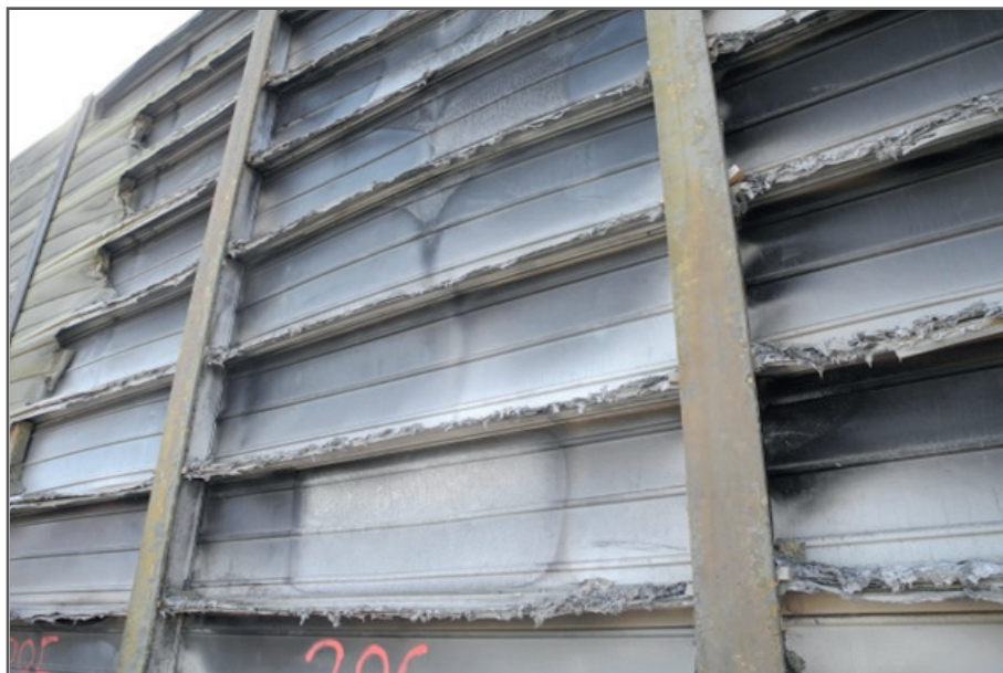
Derart beschädigte Lärmschutzwände bieten nur noch ungenügenden Schallschutz (Bild: Gesellschaft für Akustikforschung Dresden mbH)
