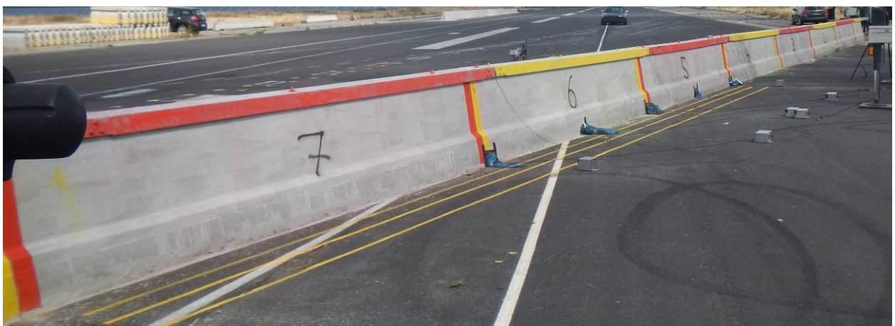
Bild 5 BSW O mit angebrachter Sanierungslösung (Ansicht von hinten gegen Anprallrichtung)
