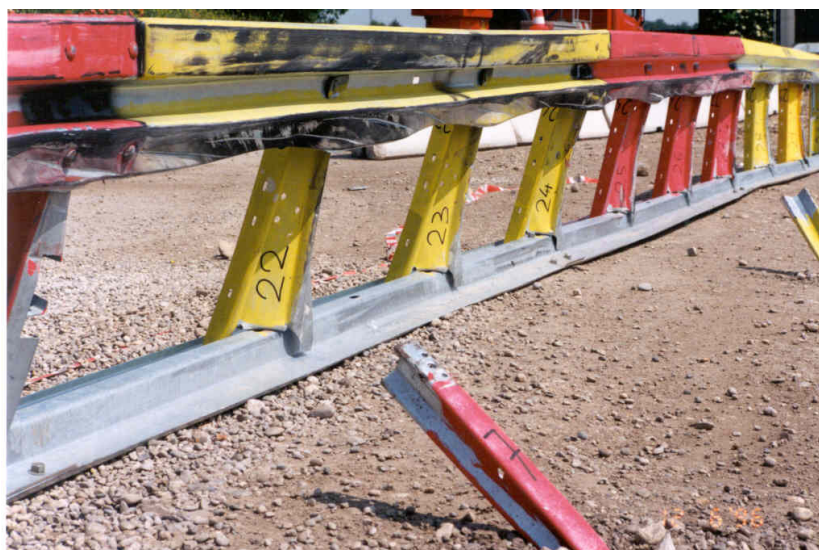
Bild 10: Detail: Schäden an Holmen 8/9
