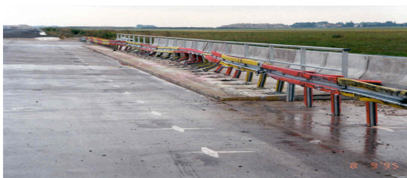
Bild 11: Schutzeinrichtung nach der Prüfung
