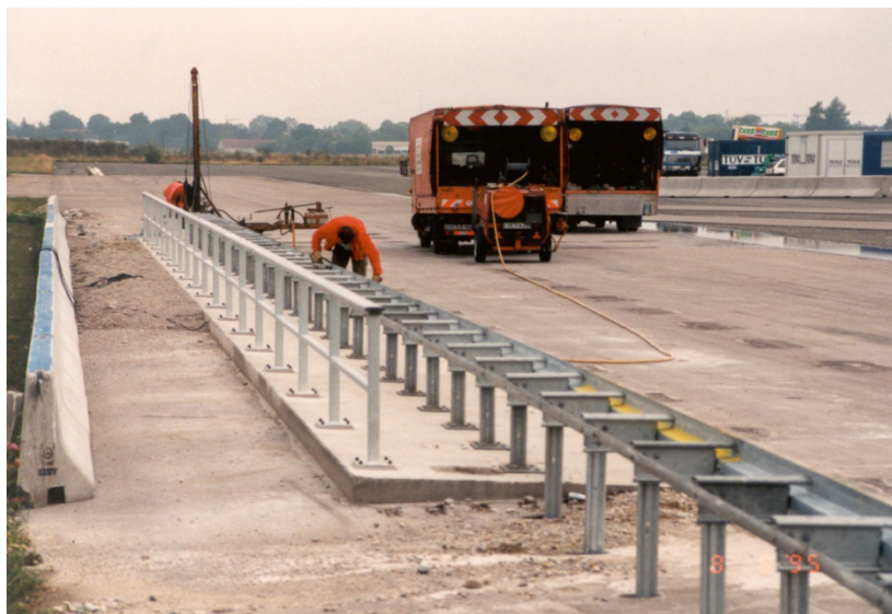
Bild 4: Übergang des Systems auf die Brückenkappe
