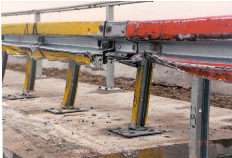
Bild 17: Schäden am Elementstoß 11/12 (Ende Brückenkappe)
