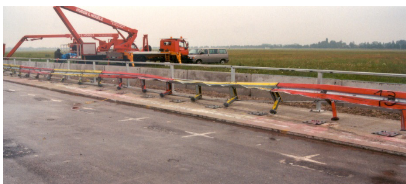
Bild 13: Detail: Schäden an den Elementen 9-13
