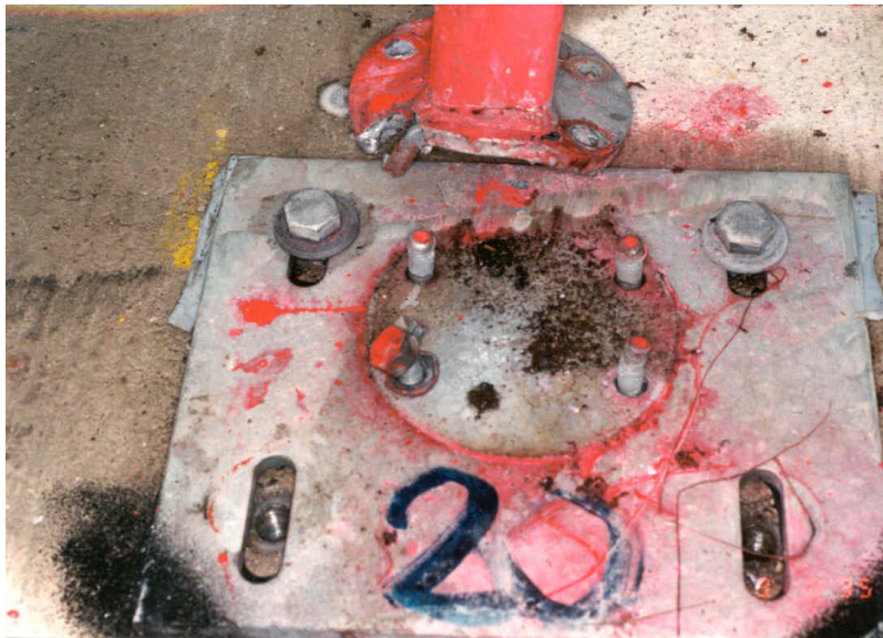
Bild 18: Detail: von der Fußplatte gelöster Pfosten
