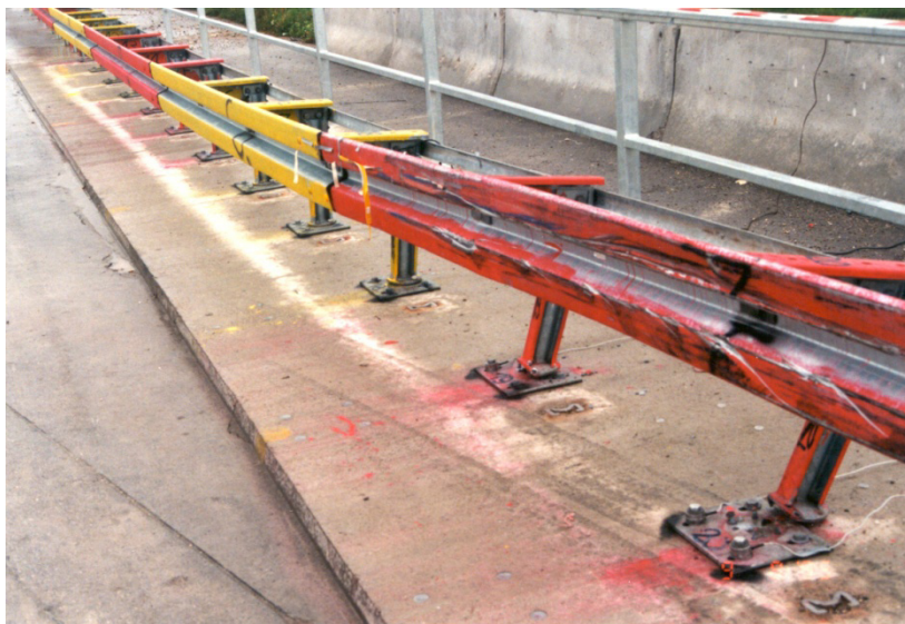
Bild 14: Schäden am tatsächlichen Anprallpunkt (Kontaktstrecke)
