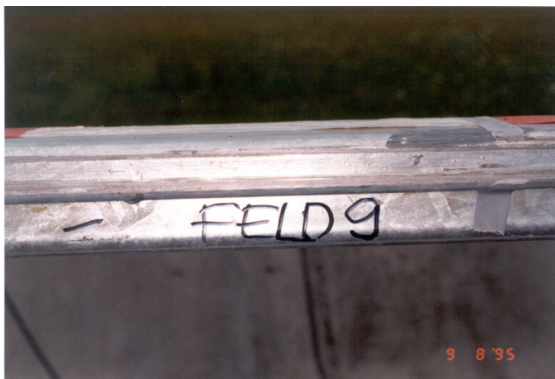
Bild 19: Detail Geländer: Anprall- spuren vom Fahrzeug
